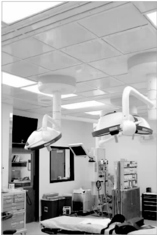
图 7 特殊用途手术室送风天花实景
