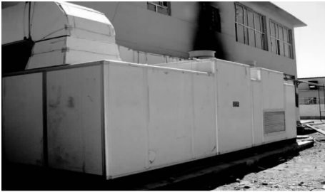
图 7 新疆巴楚某办公楼两级管式间接-直接三级蒸发冷却空调机组实景图
