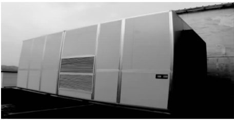
图 6 管式间接+直接两级蒸发冷却空调机组(过滤段采用卷帘式空气过滤器)实景图
