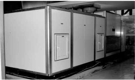
图3 兰州某网吧管式间接-直接 两级蒸发冷却空调系统实景图
