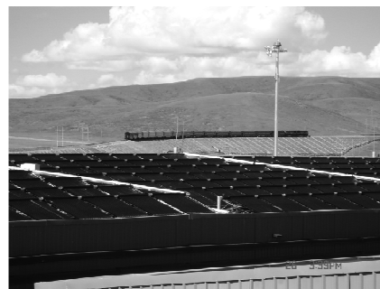
图 2 集热器现场实景
