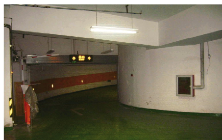
图 2 地下车库出口处的消火栓和消防管道(测点 4)
